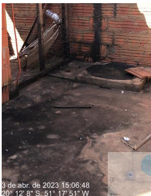
Figura 124. Fossa negra em residência na zona rural. Fonte: Visita técnica, 2023.
