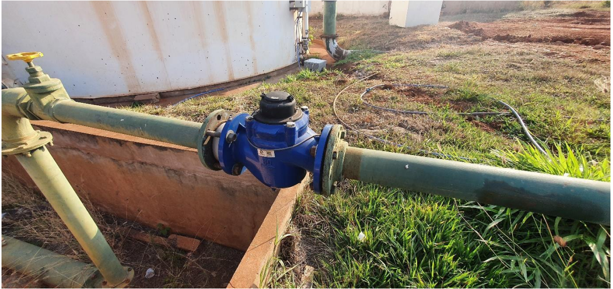
Figura 73 – Macromedidor na saída da EEAT-02 Fonte: Visita técnica
