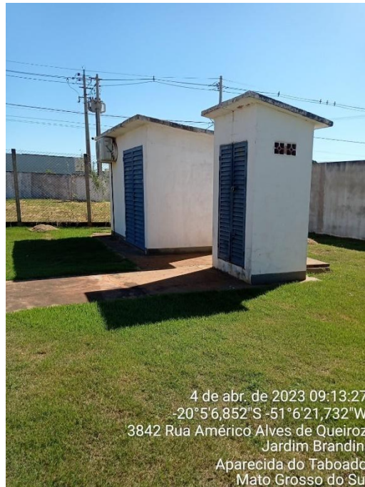
Figura 74 – Casa do Gerador próximo ao poço APT-015. Fonte: Visita Técnica.
