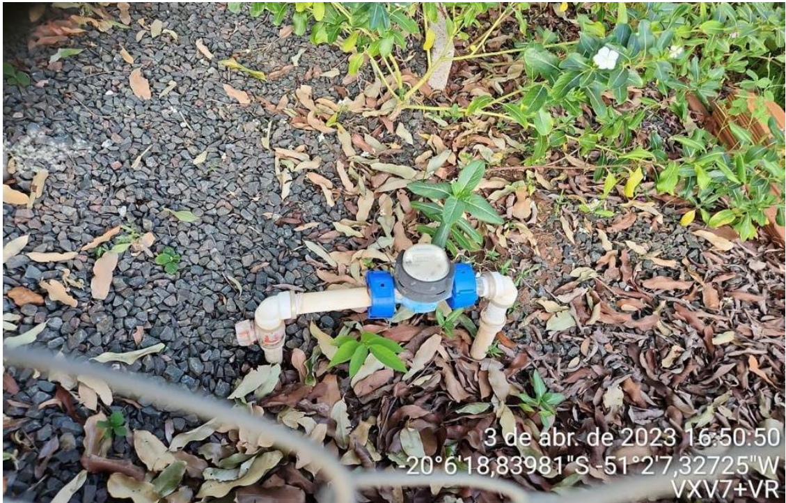
Figura 44 - Cavalete de água instalado em residência do loteamento Andaraluá II.
