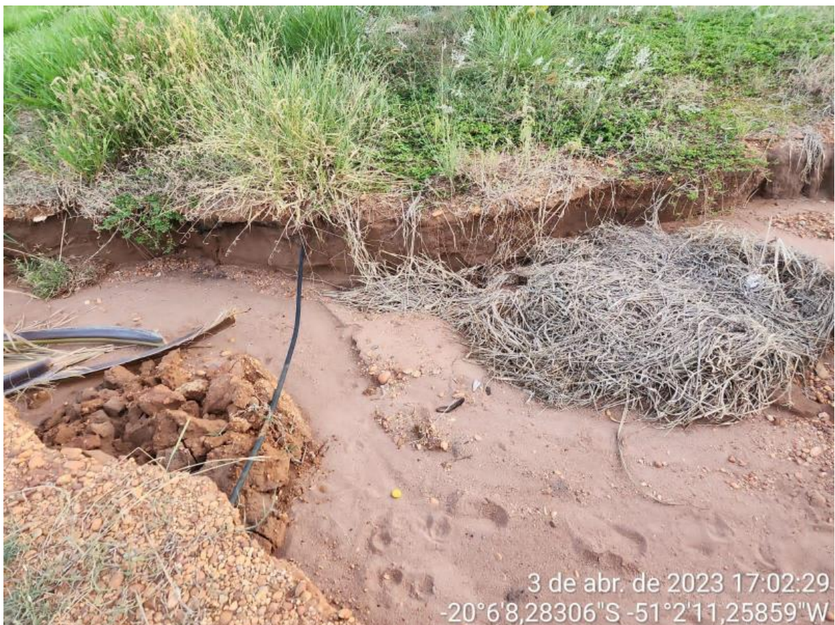
Figura 43 - Rede de distribuição de água exposta na erosão do loteamento Anduraluá II. Fonte: Visita técnica, 2023.
