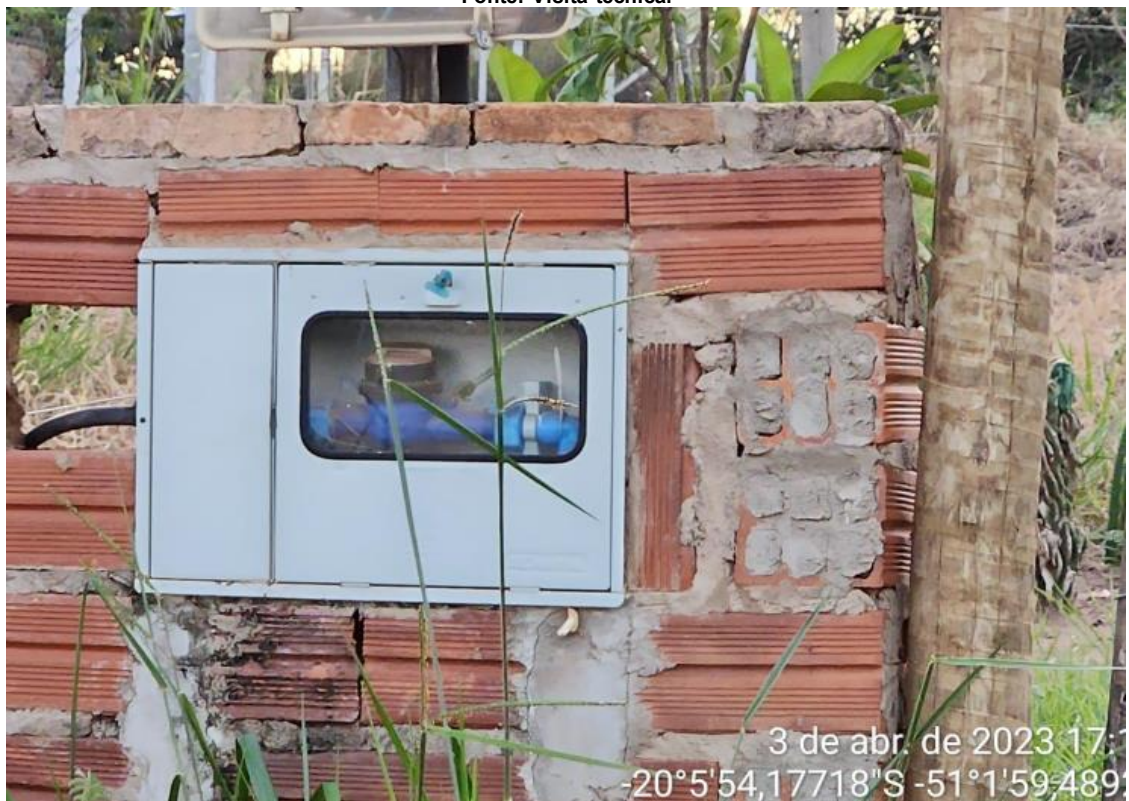
Figura 45 Caixa Padrão SANESUL, em mureta instalado em residência no Andaraluá I
