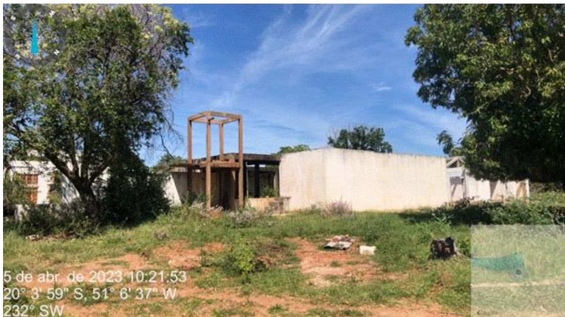
Figura 78 – Estrutura do reservatório de retrolavagem dos filtros e decantadores. Fonte: visita técnica.
