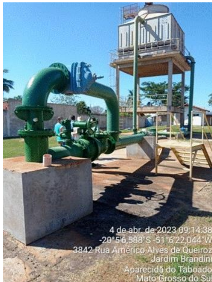
Figura 56 – Poço e Sistema de resfriamento ao fundo FONTE: Visita técnica.
