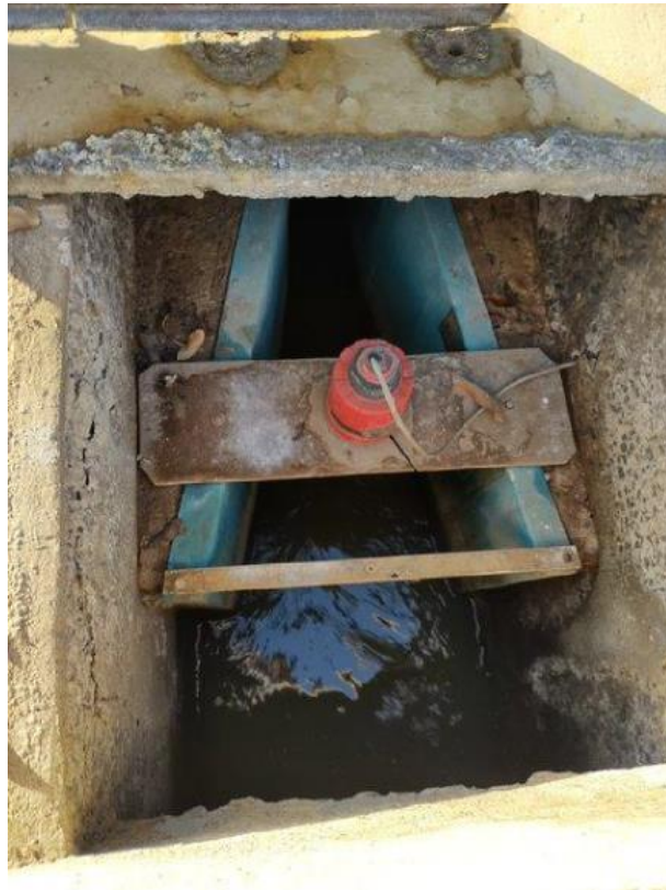
Figura 104 - Calha Parshall 6". Fonte: AEGEA.
