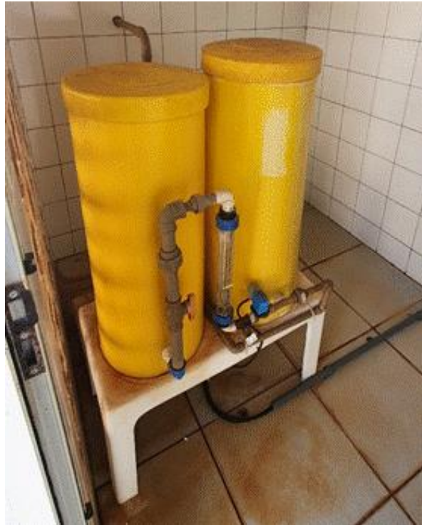
Figura 63- Diluição do cloro. Fonte: Visita técnica.
