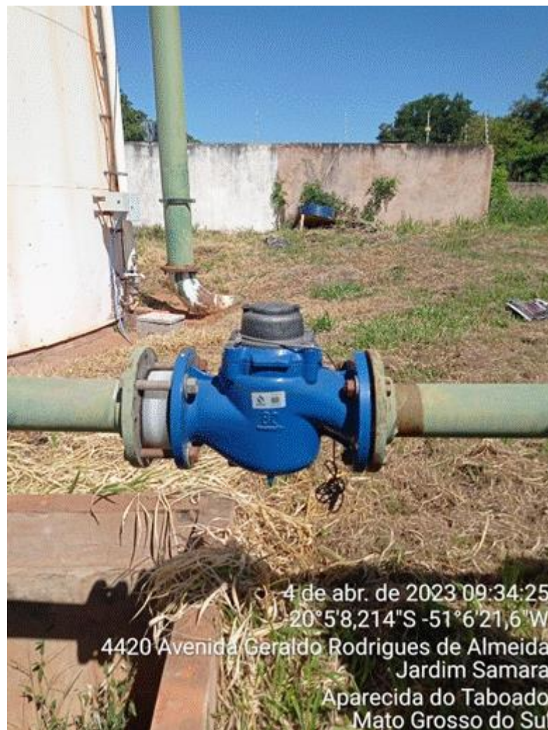
Figura 68- macromedidor na saída dos reservatórios RAP-002 e RAP-003. Fonte: visita técnica.
