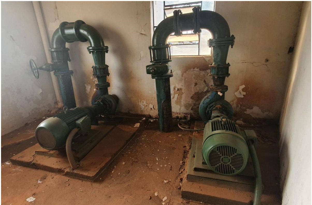
Figura 70 – Conjuntos motor bomba da EEAT-01 . Fonte: Visita técnica.
