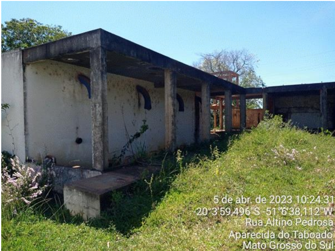
Figura 79 – Provável saída dos filtros da ETA. Fonte: visita técnica.
