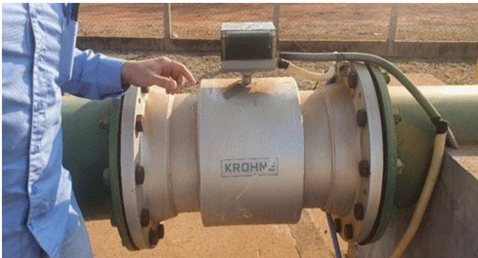
Figura 58 – Medidor de nível. Fonte: visita técnica.
