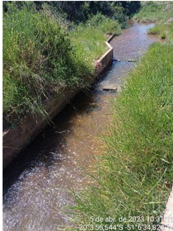
Figura 83 – Calha Parshal na saída da represa. Fonte: Visita técnica
