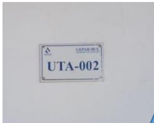
Figura 61 – Placa de Identificação da Unidade de Tratamento de Água UTA – 002 Fonte: Visita Técnica
