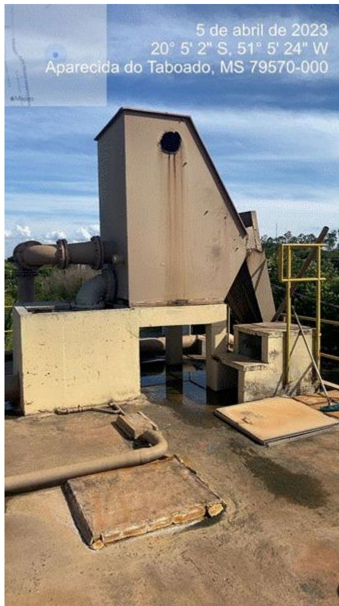
Figura 105 – Entrada do efluente no reator UASB. Fonte: Visita técnica.
