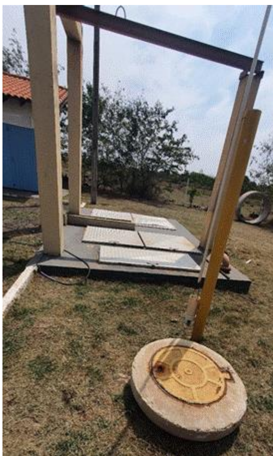
Figura 113 – Estação Elevatória de Esgoto Tratado. Fonte: Visita Técnica
