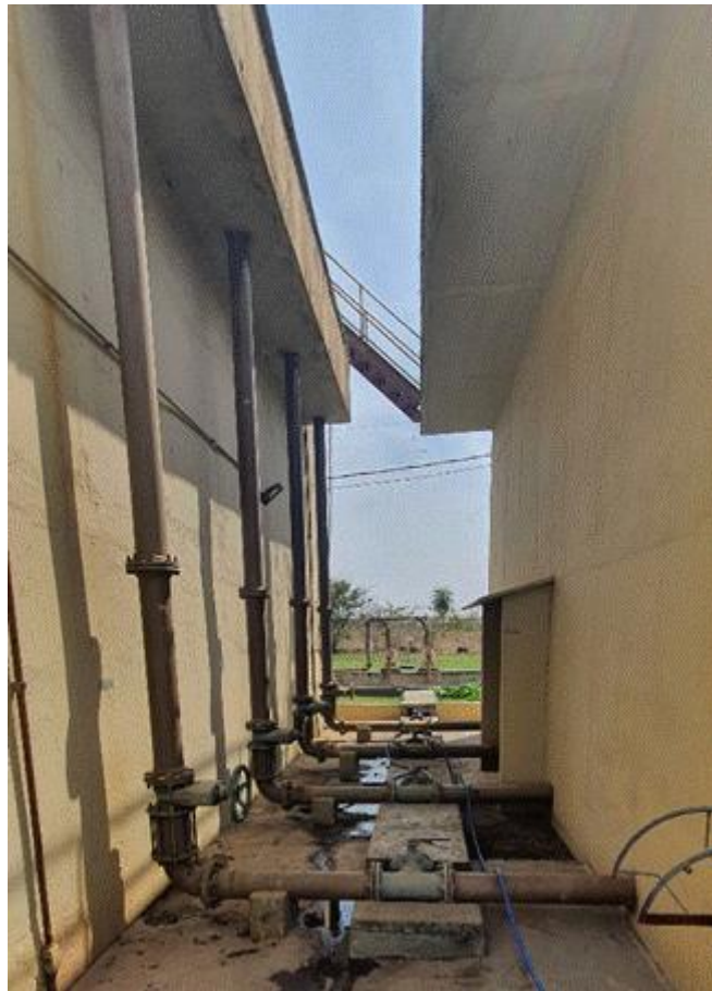
Figura 108 – Saída do efluente do UASB. Fonte: Visita técnica.
