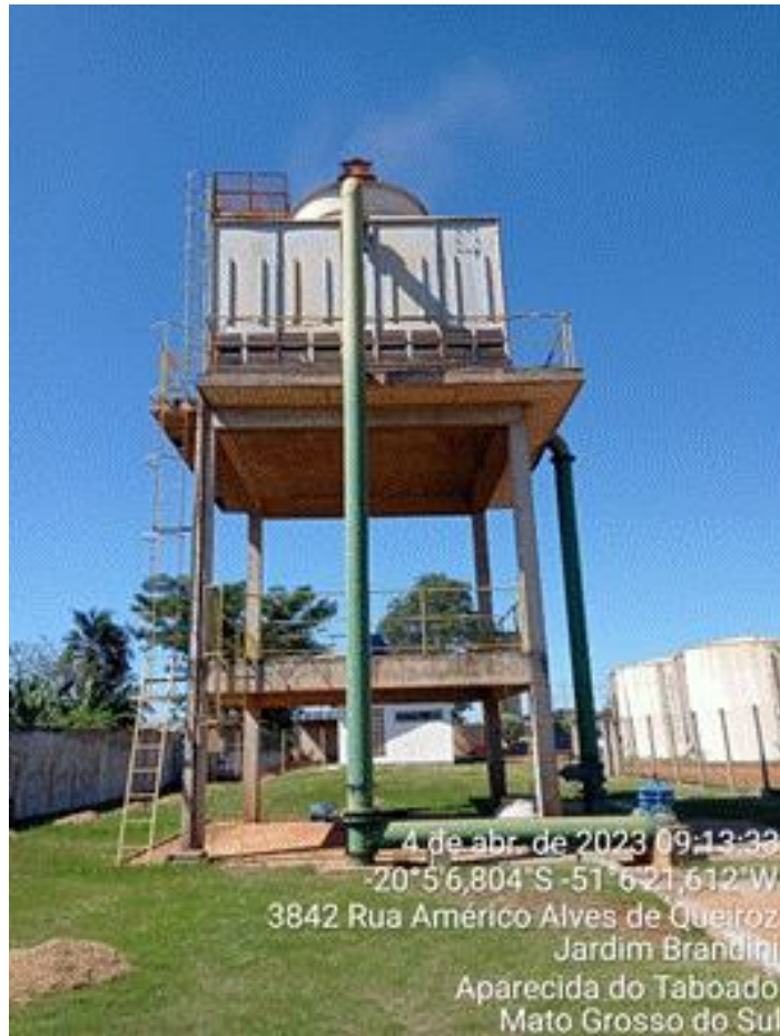
Figura 60 – Unidade de resfriamento de água bruta. Fonte: Visita técnica.
