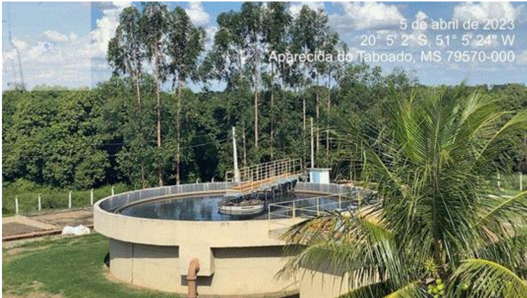
Figura 112 - Decantador. Fonte: Visita técnica.
