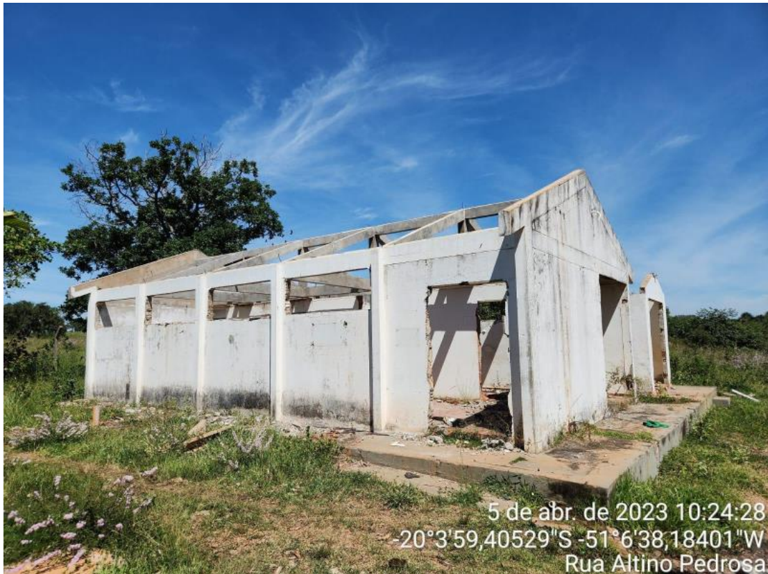
Figura 75 – Ruínas da Casa de química da ETA abandonada. Fonte: Visita técnica.
