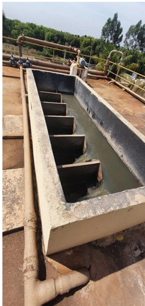
Figura 107 - Caixa de distribuição.
