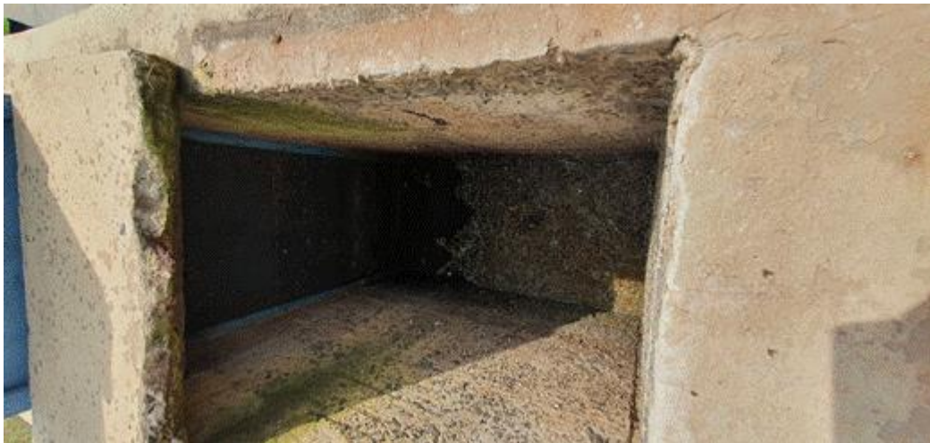
Figura 99- passagem pelo primeiro gradeamento. Fonte: Visita técnica.
