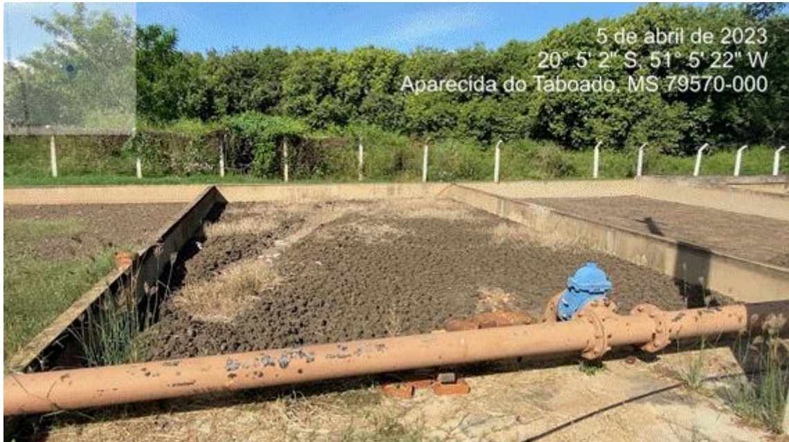
Figura 110 - Leito de secagem do lodo. Fonte: Visita técnica.
