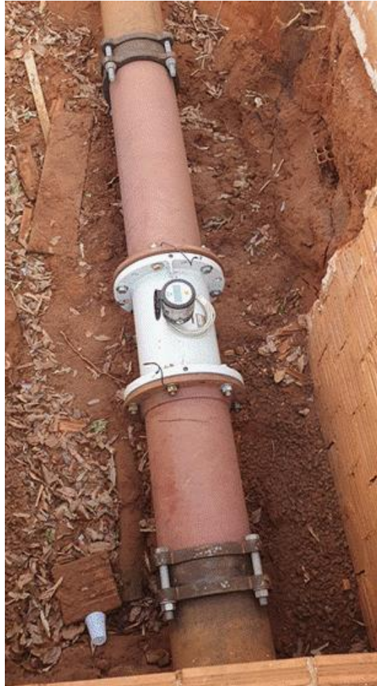
Figura 72 – Macromedidor na saída da EEAT-01 Fonte: Visita técnica
