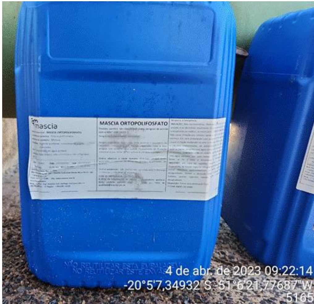
Figura 65 - Embalagem de Ortopolifosfato, adicionado durante o tratamento de água do poço APT-015. Fonte: visita técnica.
