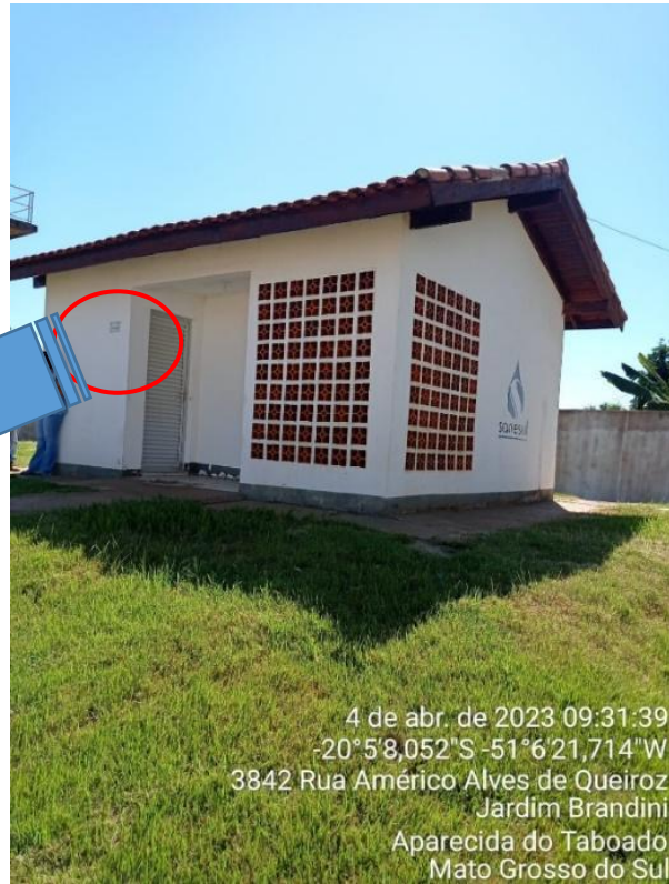
Figura 62 - Casa de cloração – UTA-002. Fonte: Visita técnica.
