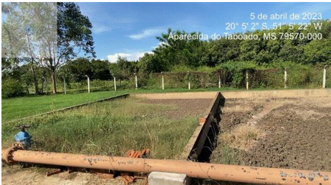
Figura 111 - Leito de secagem do lodo. Fonte: Visita técnica.
