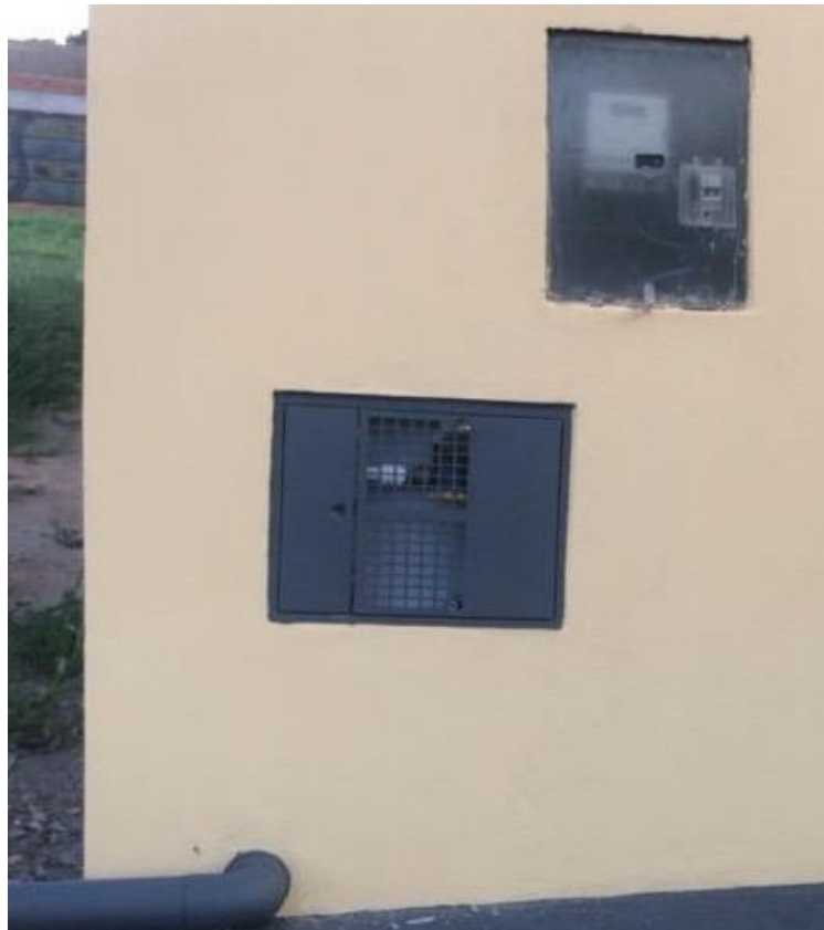
Figura 46 – Caixa padrão SABESP em muro instalado em residência no Andaralúá II Fonte: Visita técnica.
