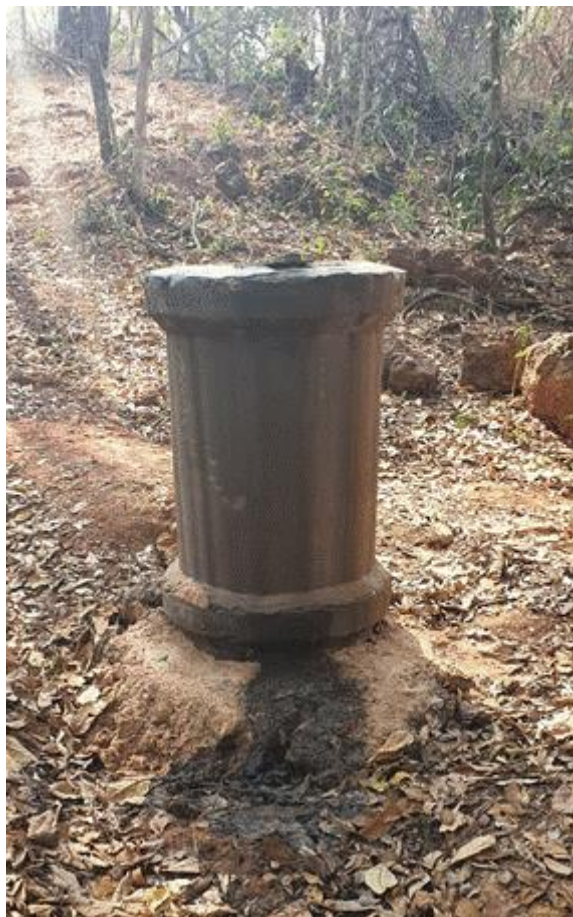
Figura 114 - Poço de visita do emissário, na parte que segue por gravidade, já próxima ao rio Paraná. Fonte: visita técnica.
