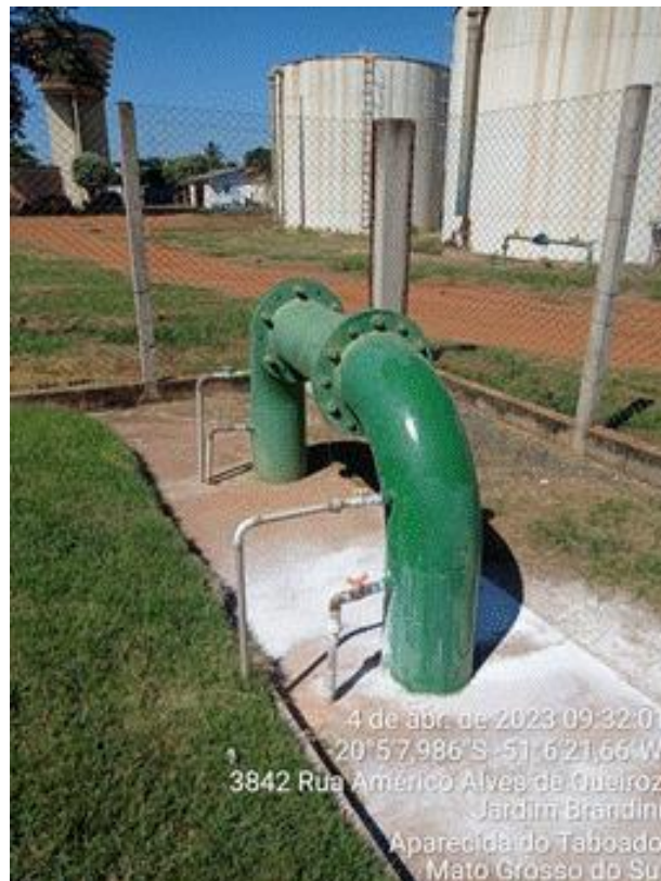
Figura 64 – Local de injeção do cloro. Fonte: Visita técnica.
