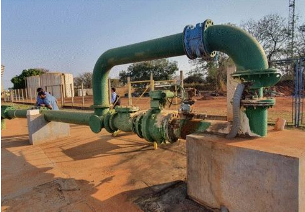
Figura 57 - Poço com proteção de laje. Fonte: Visita técnica.
