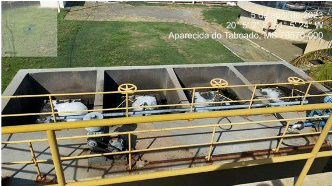
Figura 109 - Filtro aerado submerso. Fonte: Visita técnica.
