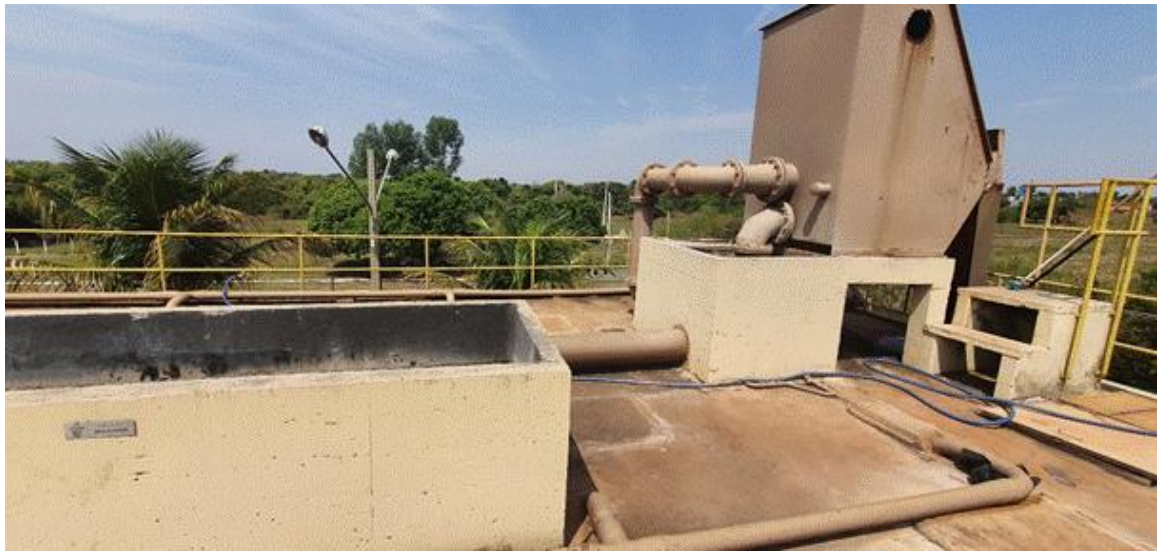
Figura 106 -Caixa de distribuição a esquerda com entrada do reator UASB ao fundo. Fonte: Visita técnica.
