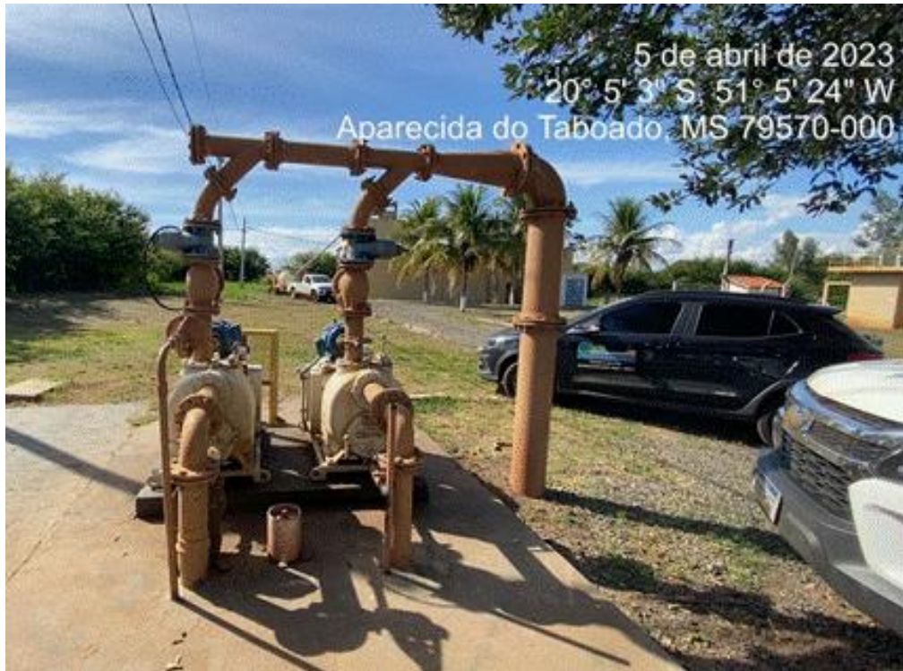
Figura 94 - Bombas e barrilete de recalque da EEEB. Fonte: Visita técnica.
